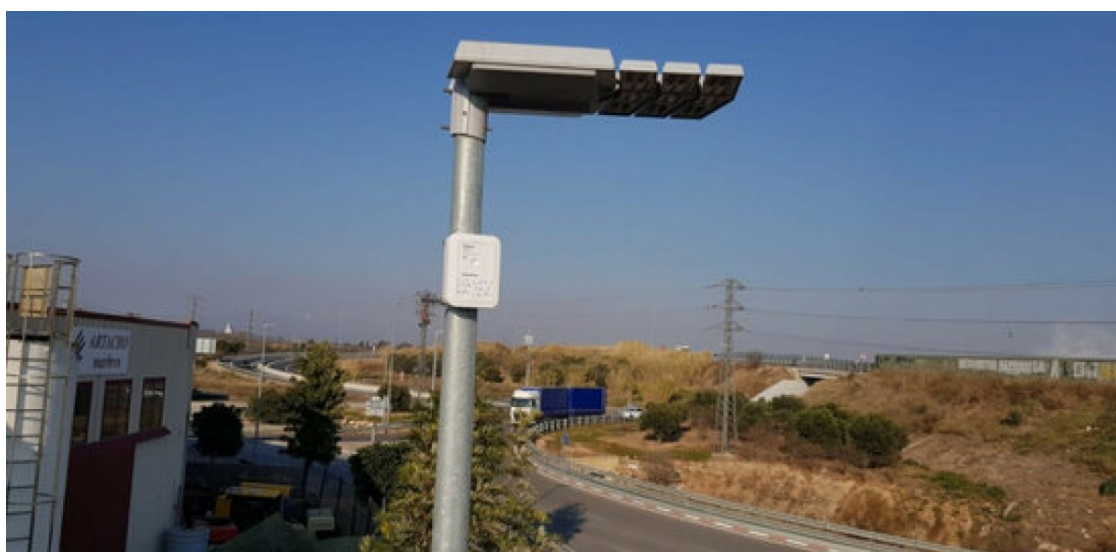
Un dels sensors detector de sulfur instal·lats al terme municipal de la Pobla de Mafumet | Protecció Civil
