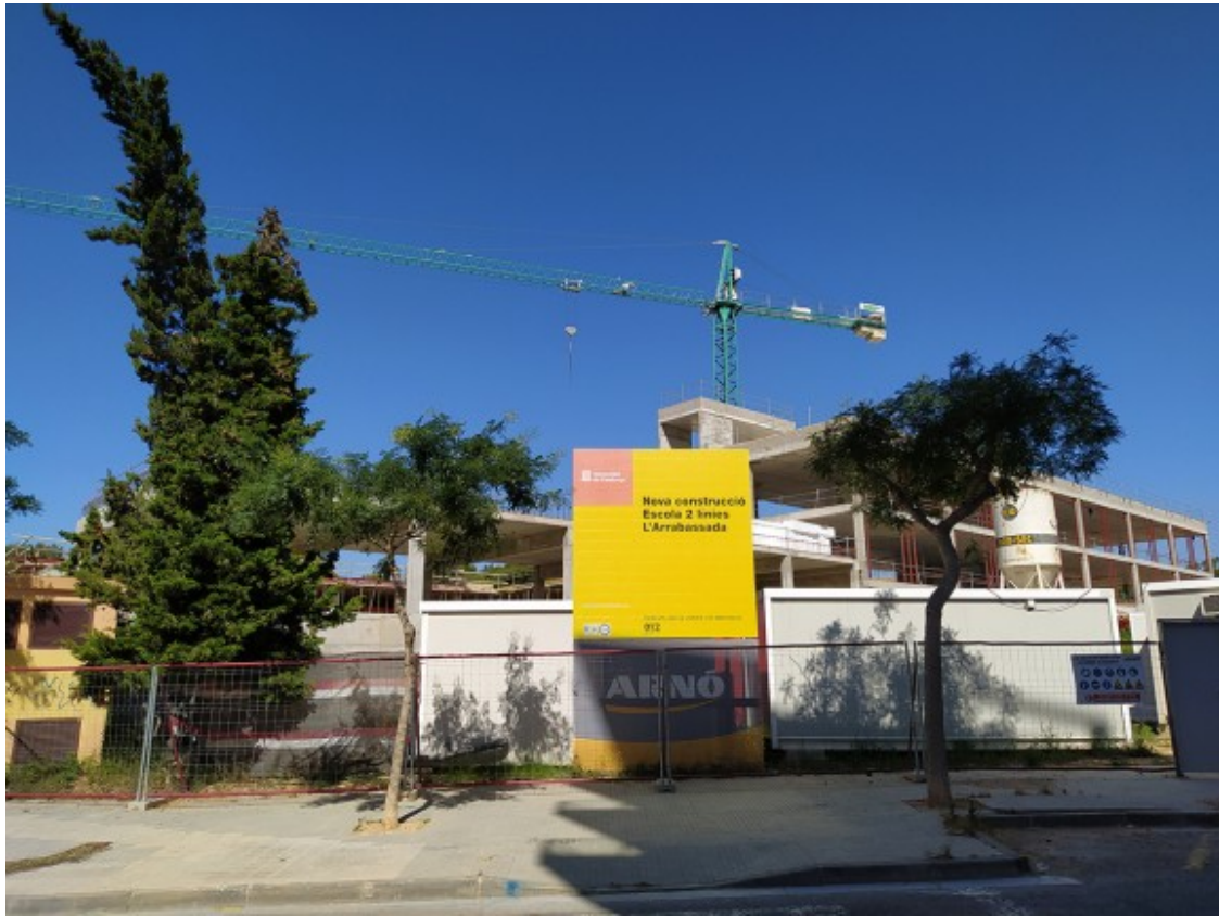
L'Escola Arrabassada, en construcció, en una imatge d'arxiu. Foto: Josep M. Llauredó
