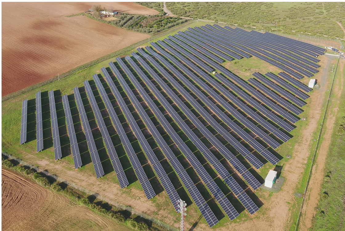
Vista general d'una planta solar fotovoltaica | ACN
