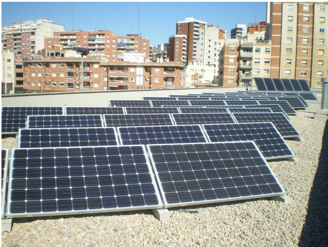
Una instal·lació municipal de plaques fotovoltaïques a Reus. | Ajuntament de Reus
