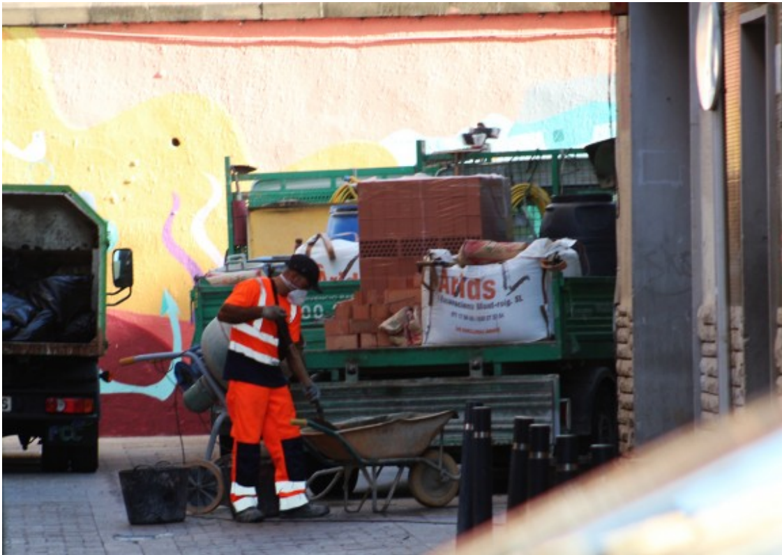
Un operari, en els treballs per tapiar alguns dels pisos de l'edifici del carrer Sant Andreu de Tarragona. Foto: Josep M. Llauradó
