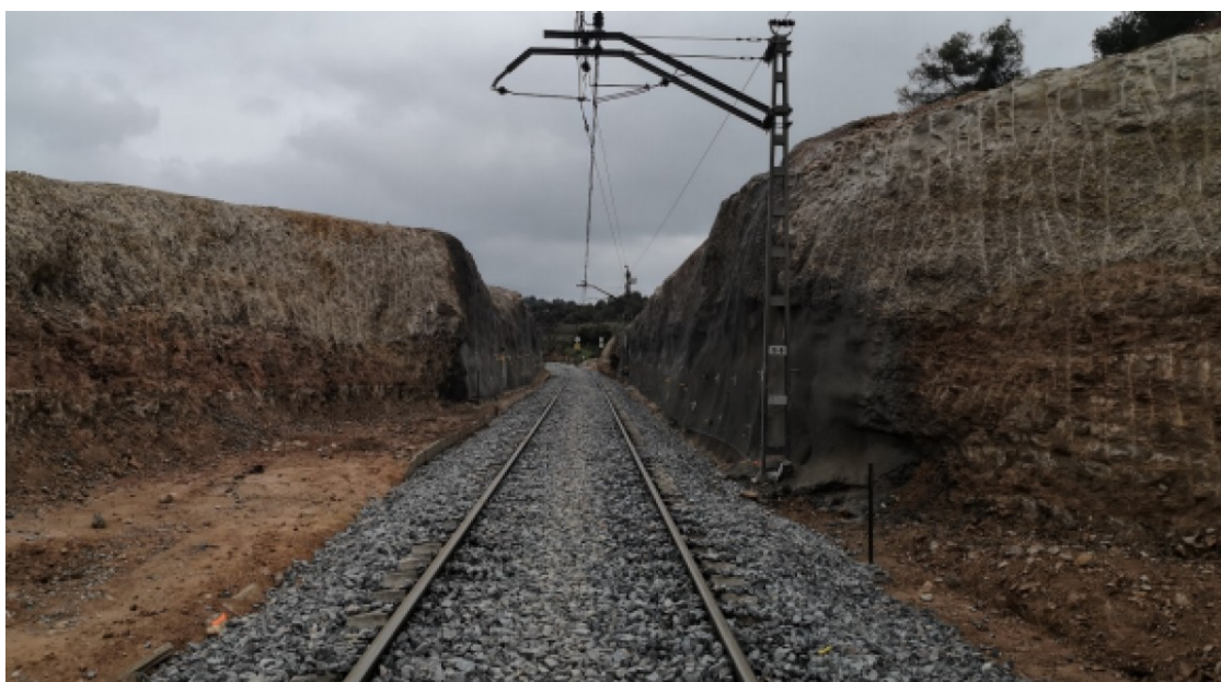
Imatge de la línia arranjada després del temporal | Adif
