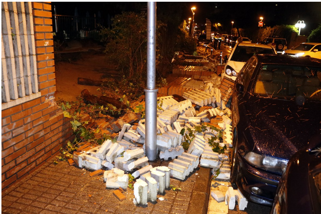
El mur que va cedir per la pluja al carrer Murillo, ahir a la nit | ACN/Roger Segura
