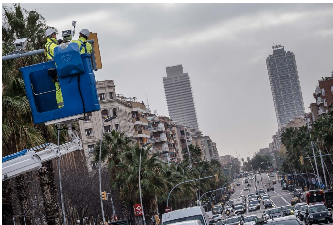
Instal·lació de càmeres per controlar la ZBE al carrer Marina | Adrià Costa
