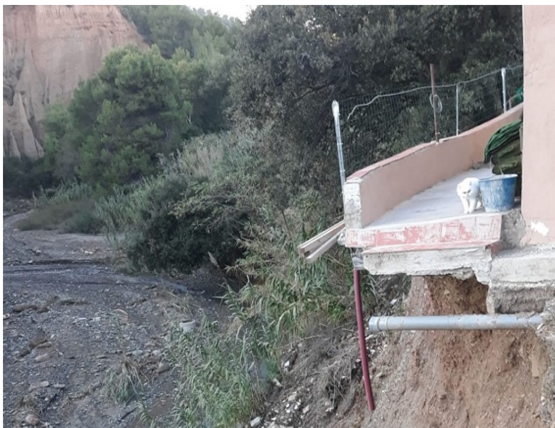
Estat d'una de les cantonades de la casa, provocat pel creixement de la riera. | Família Gonzalez Castro
