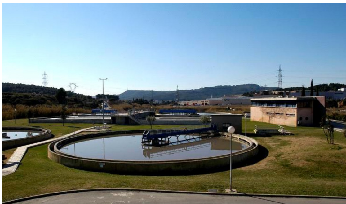
La depuradora de Rubí | ACA
