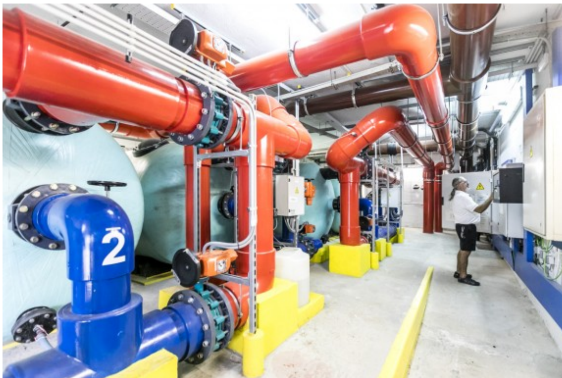
Un operari comprova el sistema intern de La Bassa. Foto: Juanma Peláez
