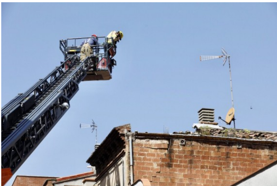
Els Bombers inspeccionant els desperfectes Foto: Juanma Peláez
