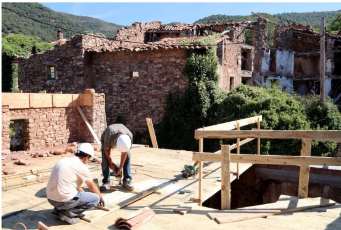
Dos operaris treballant en la rehabilitació d'un edifici al poble d'Envall. Foto: ACN
