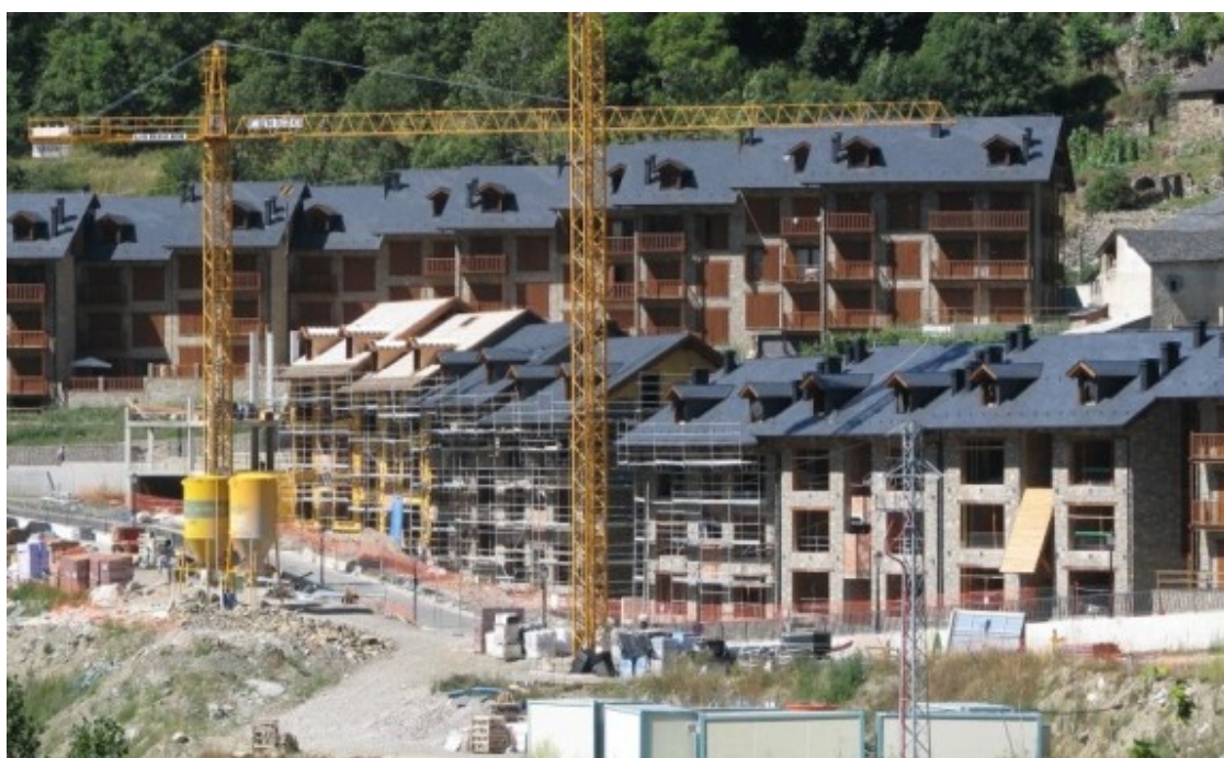
Les obres del complex d'Espui van quedar paralitzades el 2008. Foto: Arxiu ACN
