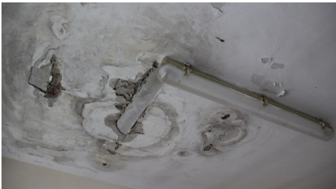
Estat del sostre del vestidor local del Pedrasanta, amb filtracions d'aigua. Foto: Jordi Ubach
