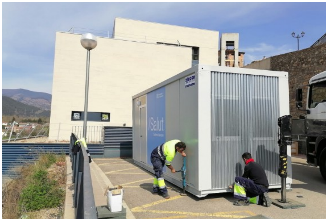
Operaris finalitzant la instal·lació del mòdul a la Pobla de Segur. Foto: Salut
