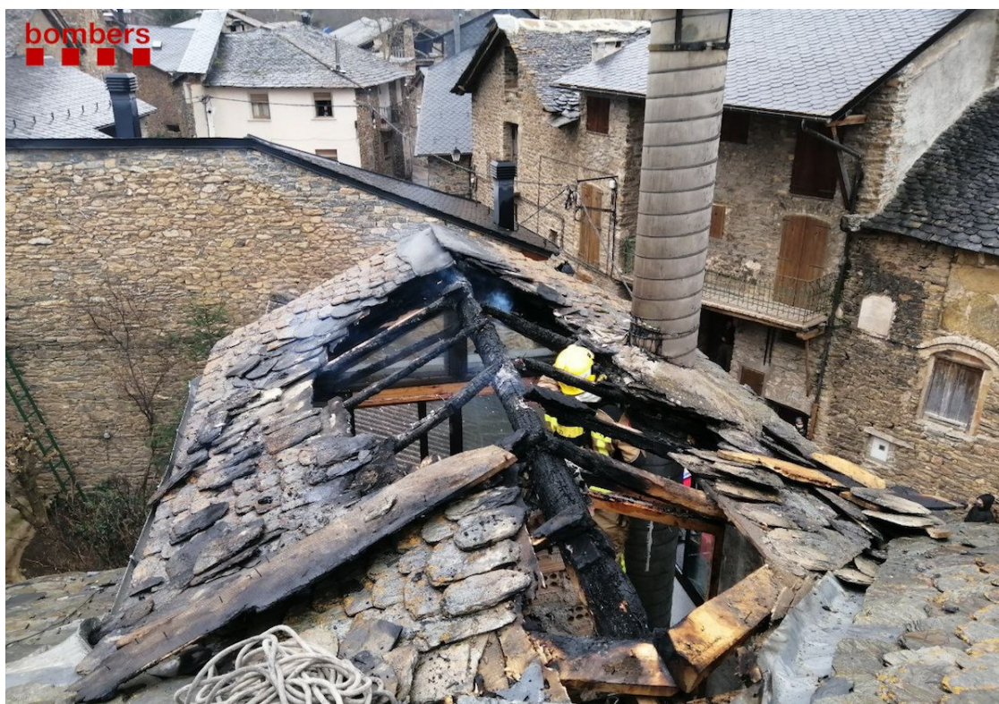
Imatge de la teulada afectada a Altron | Bombers
