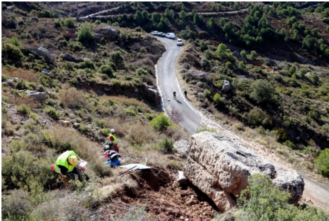
Pla general de la roca que amenaçava de precipitar-se a la carretera d'Hortonedà. Foto: ACN
