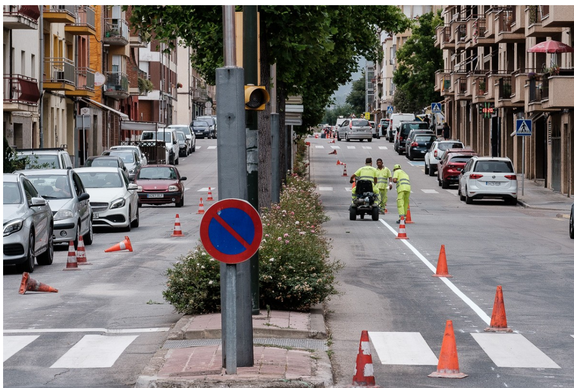
Inici de les obres del carril bici a l'avinguda de Roma | Adrià Costa
