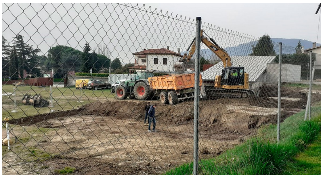
Les obres al Camp de les Lloses de Tona | Consell Comarcal d'Osona
