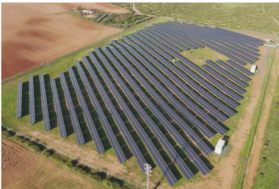
Vista general d'una planta solar fotovoltaica. | ACN
