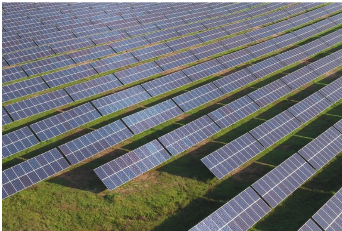
Vista general d'una planta solar fotovoltaica. Foto: ACN
