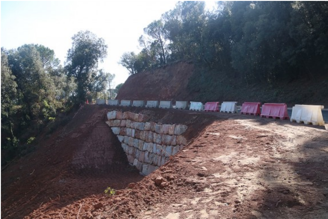
La carretera principal de Vilanova de Sau després que hagin arreglat l'esvoranc. Foto: ACN
