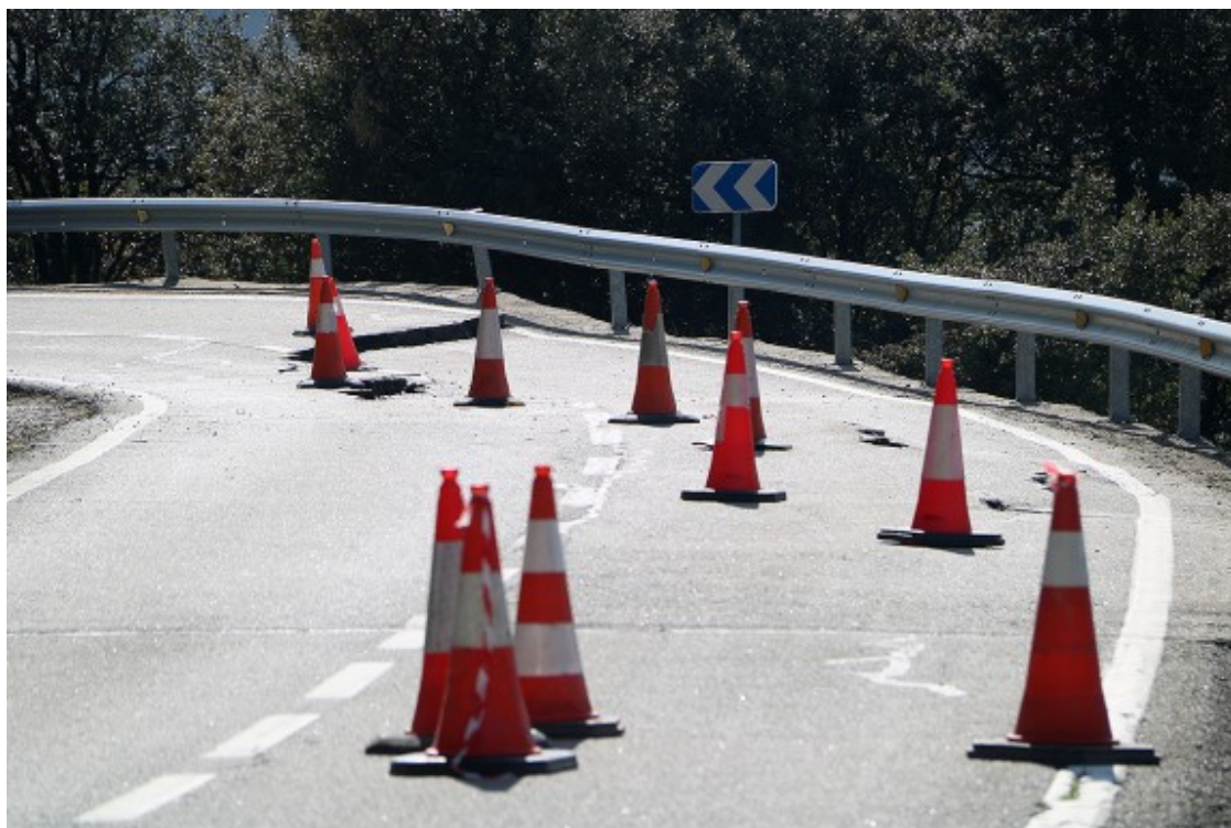
El ferm de la carretera BV-5301 que s'ha enfonsat com a conseqüència del temporal Gloria Foto: ACN
