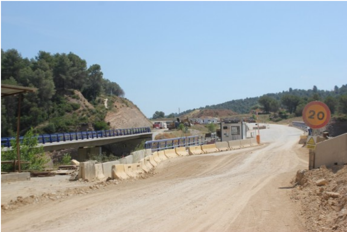
Pont de la B-40 sobre la riera de Sant Jaume, a Terrassa. Foto: Albert Prieto
