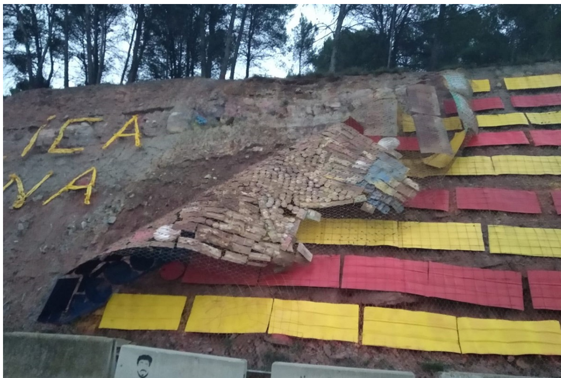
Xarxa metal·lica arrencada a la carretera a Castellnou | Cedida
