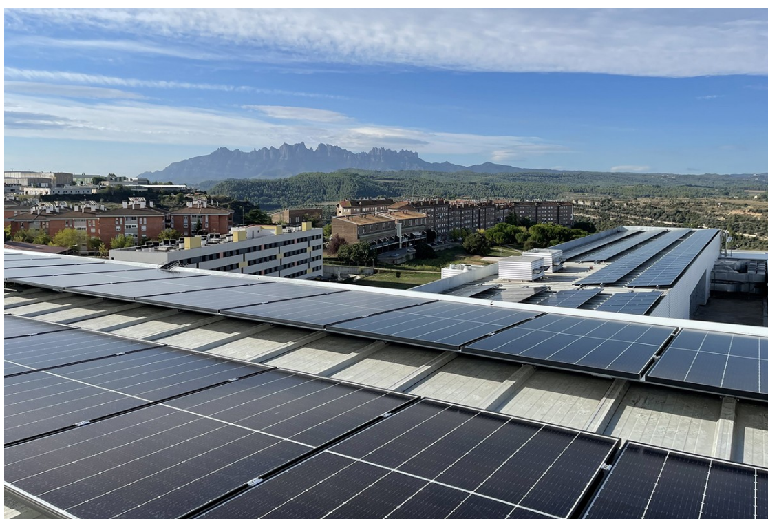
Plaques solars a l'hospital Sant Joan de Déu | Althaia
