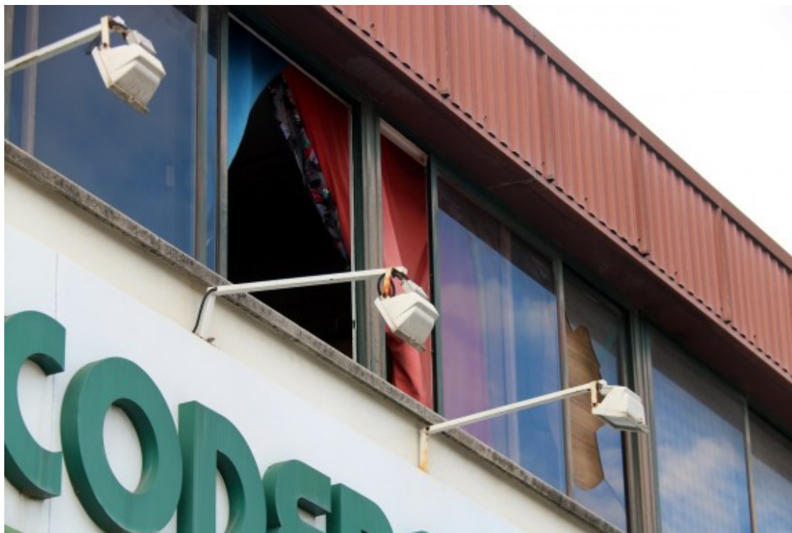
Detall d'unes finestres d'una de les naus abandonades de la carretera Barcelona de Girona. Foto: ACN
