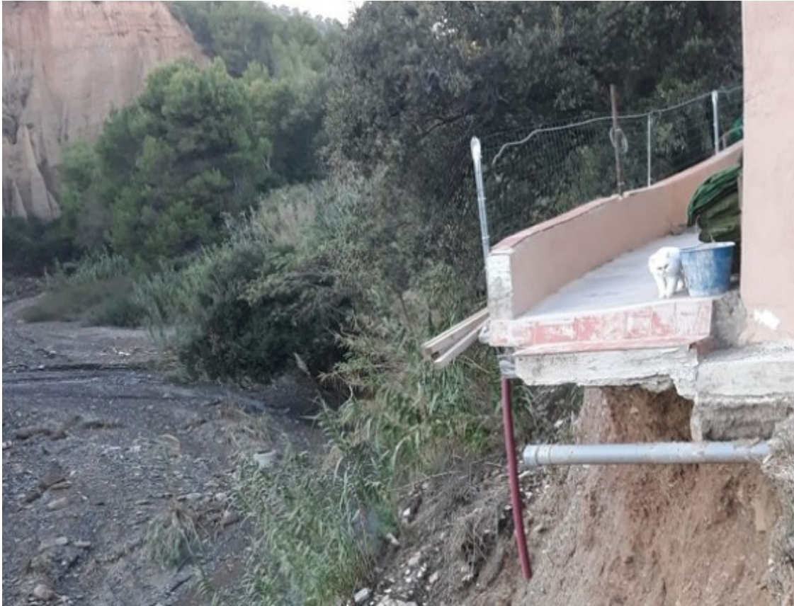
Una part del pati de la casa es troba penjant per falta de fonaments. Foto: Família Gonzalez Castro
