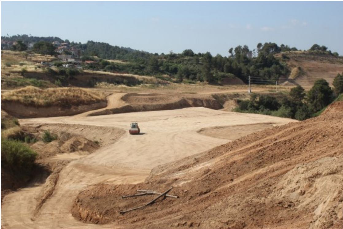
Obres de la B-40 al terme de Viladecavalls, a prop del futur enllaç amb la C-16. Foto: Albert Prieto
