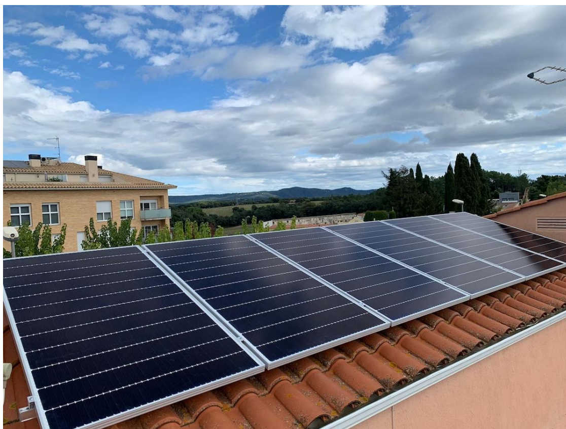
Plaques solars fotovoltaïques en un teulat. | @diputaciogirona.
