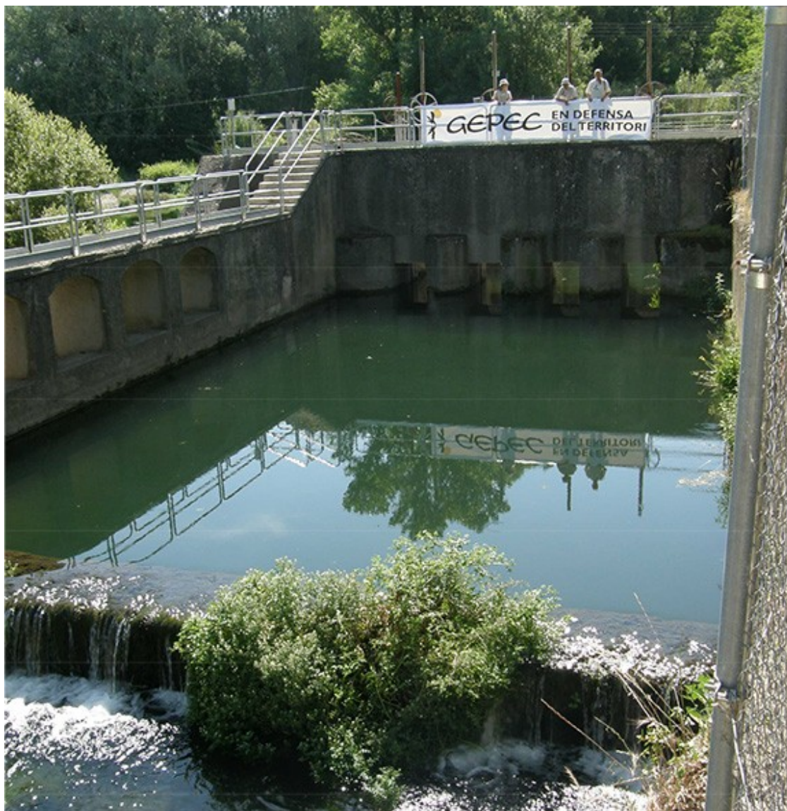
La represa del Siurana, aigües avall del pantà. A partir d'aquí, l'aigua del riu es desvia cap a Riudecanyes. Foto: Aniol Poblet / GEPEC.
