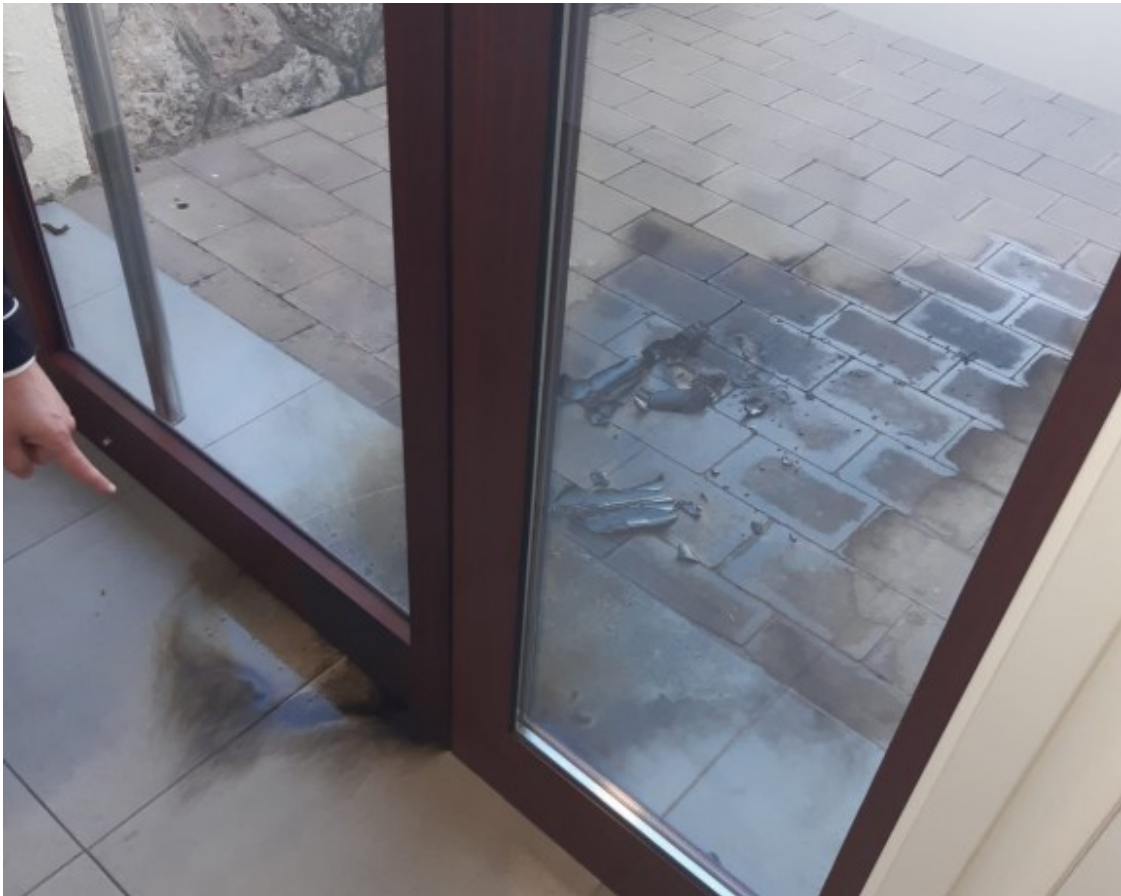
L'atac va provocar un petit incendi i desperfectes a la porta de l'edifici. Foto: Ajuntament de Matadepera
