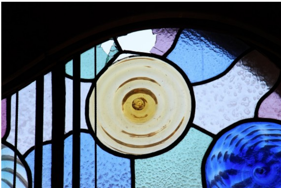
El vitrall afectat pel llançament d'una pedra Foto: ACN
