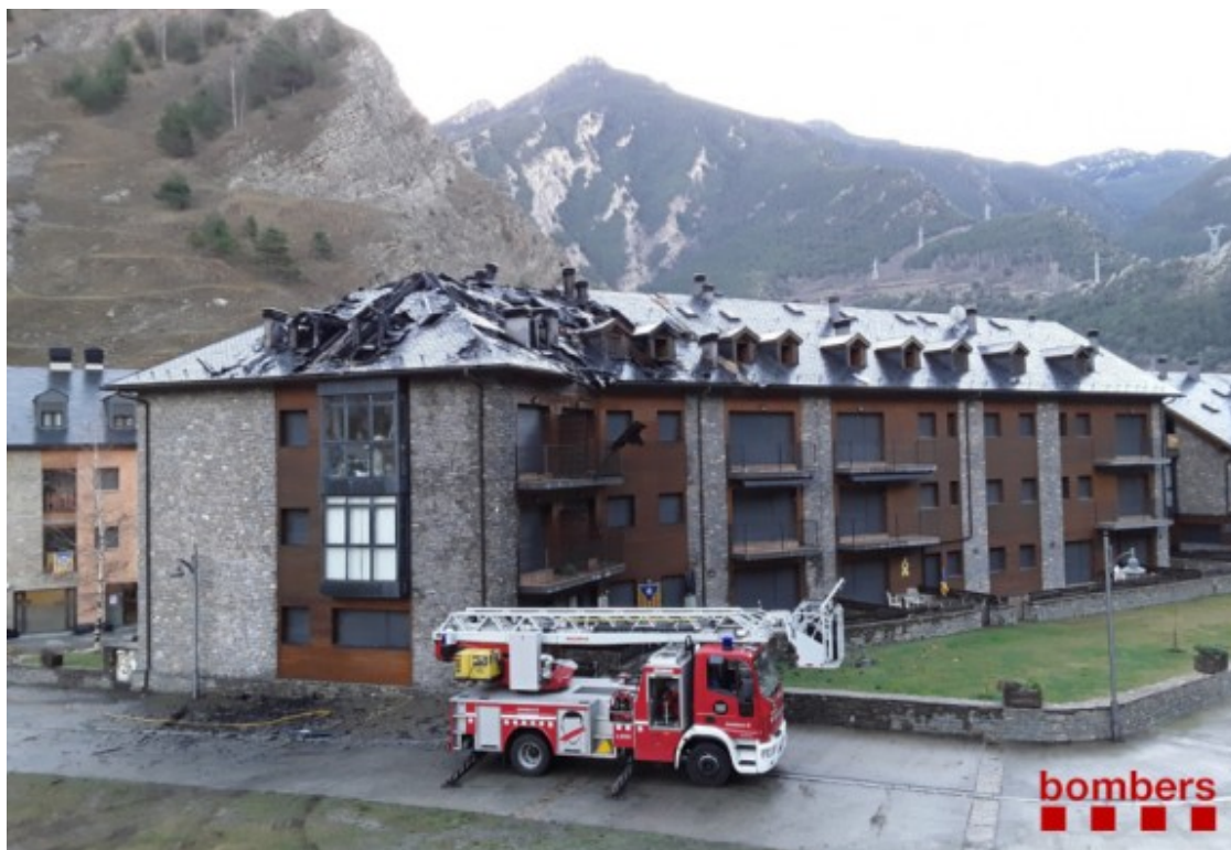
Així ha quedat la teulada de l'edifici afectat. Foto: Bombers
