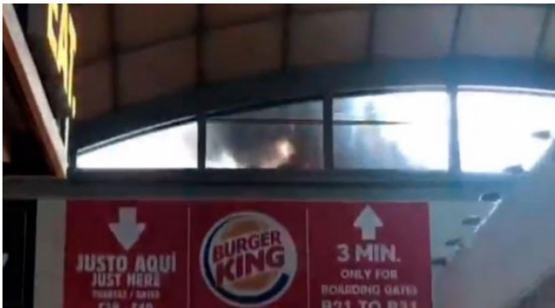
Incendi al sostre de l'Aeroport d'Alacant Foto: Ajuntament d'Alacant
