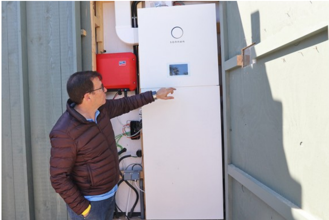
Toni Castellar amb una de les bateries dels bungalows. Foto: Albert Alemany
