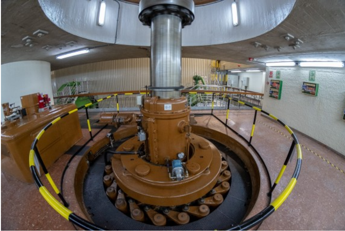
L'alternador d'una de les turbines de la central de Susqueda. Foto: Josep Maria Montaner
