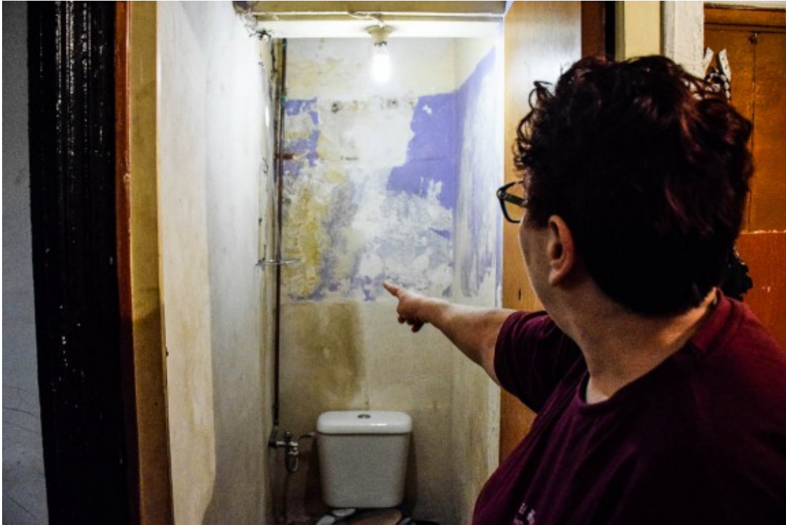
El lavabo d'Ángeles Prades molt deteriorat per les humitats. Foto: Maria Rubio
