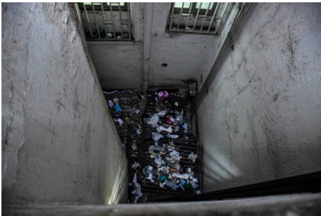
Un celobert ple d'escombraries d'un dels edificis del carrer Lancaster. Foto: Maria Rubio
