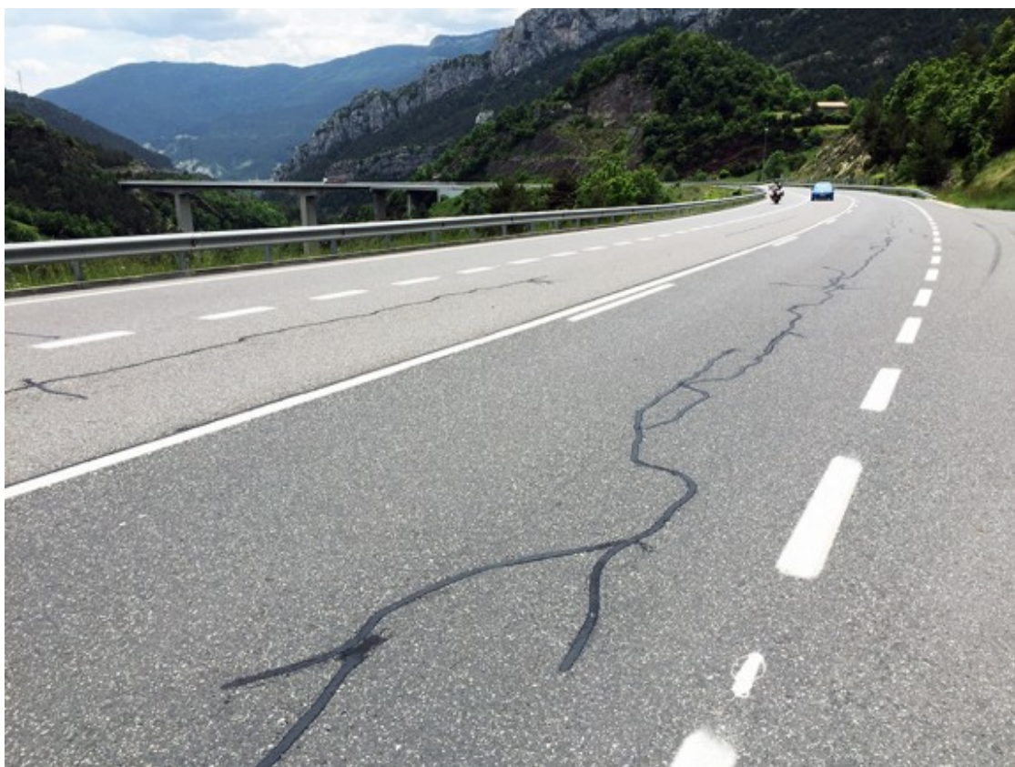
Una imatge general de la carretera, amb les tires de mastic ben visibles a l'asfalt
