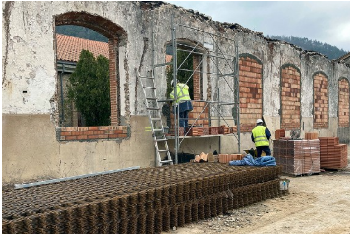
Uns operaris treballant a la nau sinistrada. Foto: ACN
