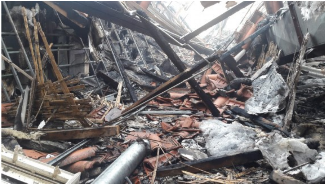
La nau sinistrada. Foto: Protecció Civil de Ripoll
