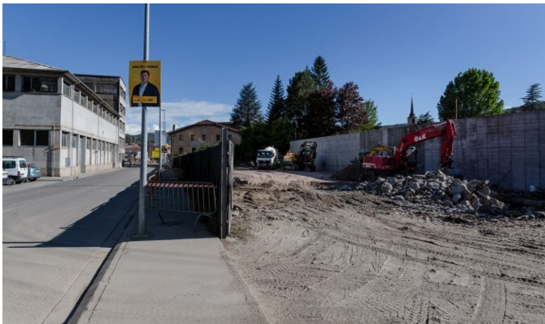
Obres de construcció del mur de construcció a la futura premsa de Comforsa. Foto: Adrià Costa
