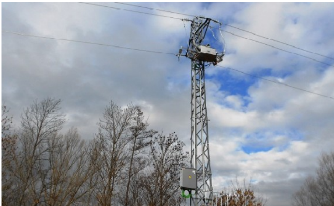
Imatge d'una de les torres dotades amb la nova tecnologia Foto: Endesa
