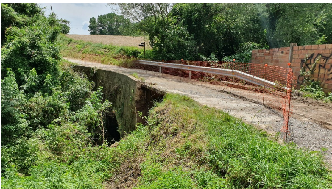
Esfondrament parcialment al pont de la Fàbrega, a Berga. | Aj. Berga
