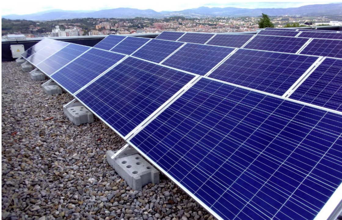
Plaques fotovoltaïques (arxiu).
