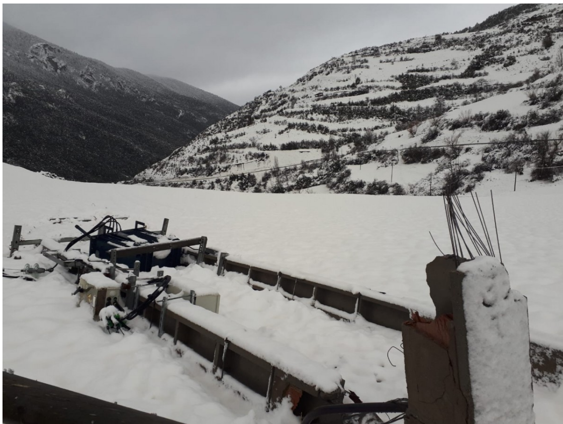
Una torre elèctrica caiguda a Vallcebre, al Berguedà. | Endesa
