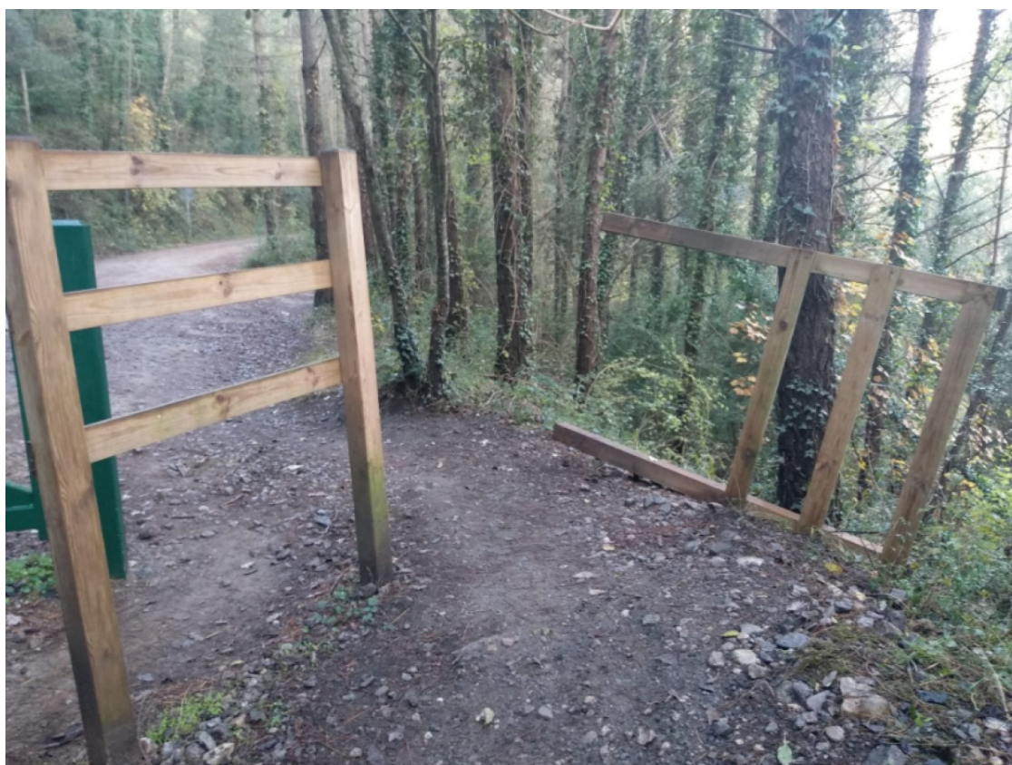
Una de les tanques de fusta malmeses. | CC Berguedà
