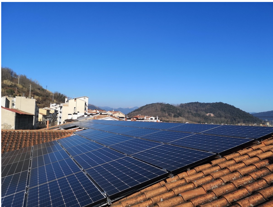
Plaques solar en una teulada. | Arxiu
