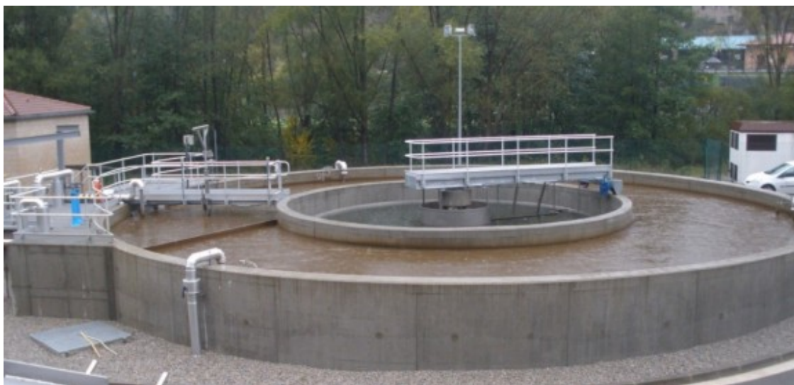
Depuradora d'aigües residuals de la Pobla de Lillet. Foto: Consell Comarcal del Berguedà
