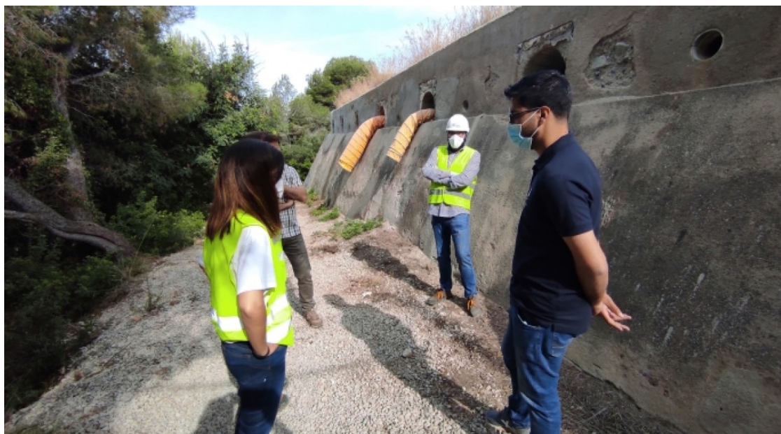
Un dels dipòsits de Calafell | AC
