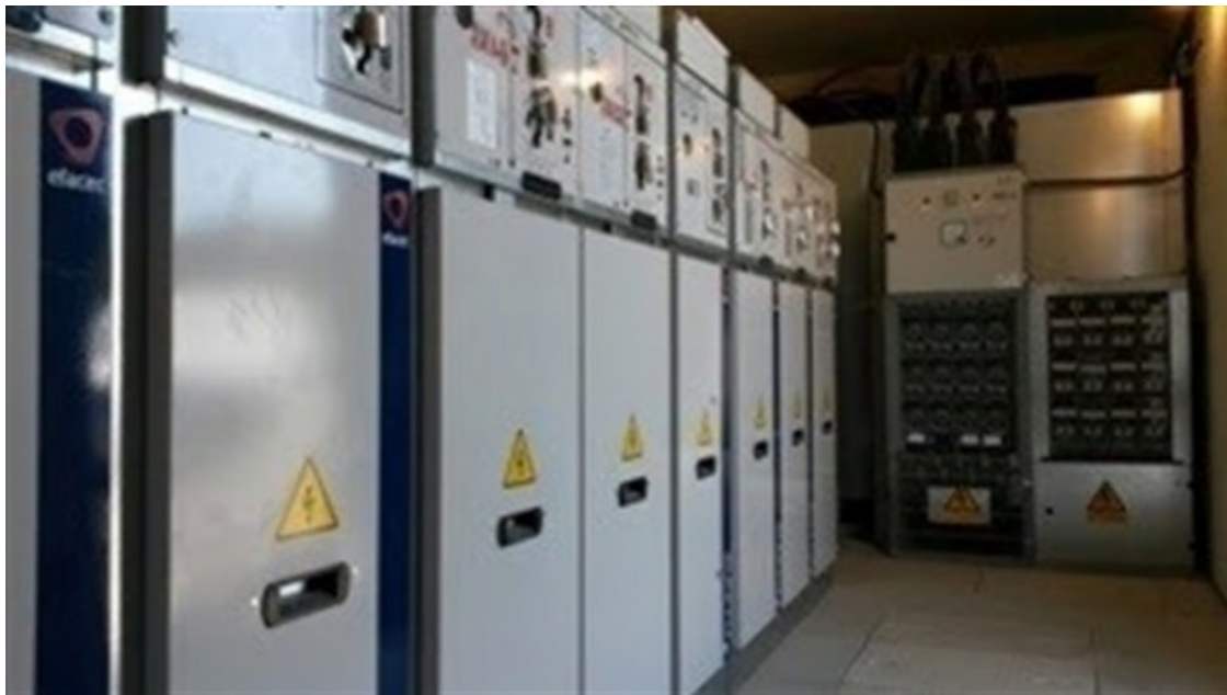
Centre de transformació de Sant Feliu de Buixalleu | Endesa
